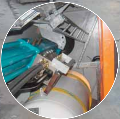
Detalhe dos módulos de conversão de energia
